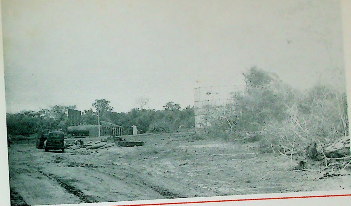
Para la construcción de la carretera Maturín-Perro Seco, la empresa suministraba el camión y su conductor, y el Presidente Ducharme pagaba los obreros que extraían la arena.
