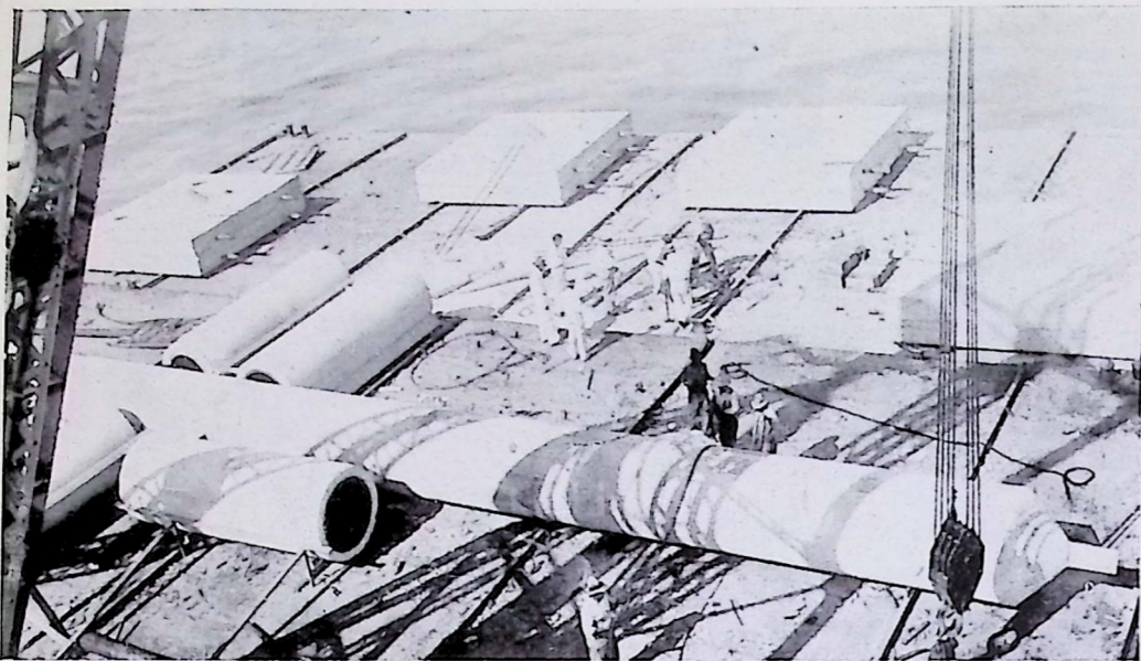
Uno de los "pilotes" listo para ser colocado en el agua. Igualmente puede apreciarse los cuadros de cemento que se emplean para que alcance la profundidad necesaria.
