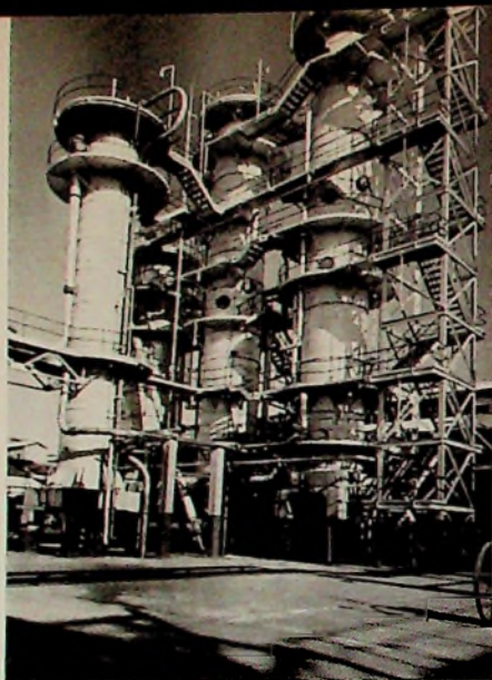
Cracking — Refinería Cardón.
